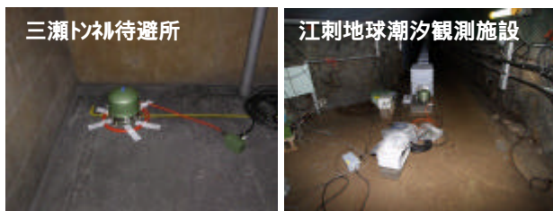
写真-1 測定装置の設置状況
