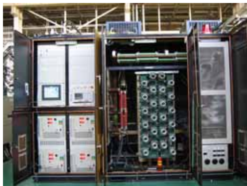
図4 4台のインバータ電源がインストールされた電源の内部写真
